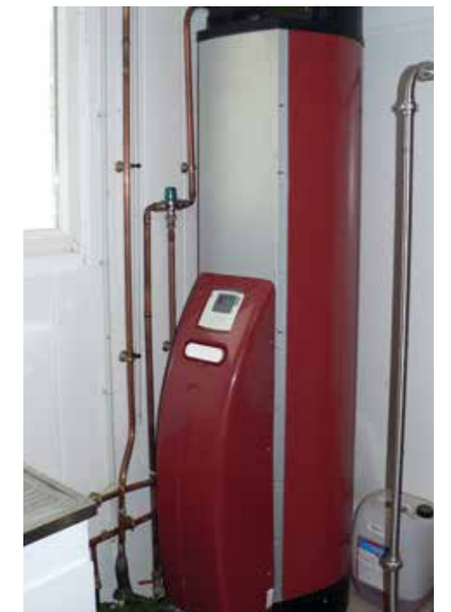
Ballon d'eau chaude solaire
